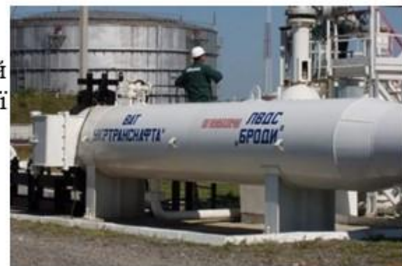
Рисунок 4 – «Одеса-Броди». Нафтоперекачувальна станція
